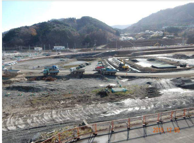
高台の町立病院から見ると、工事車が行き交う様子が分る
